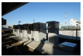
機器設置用 屋外盤
