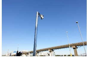
路側無線装置
